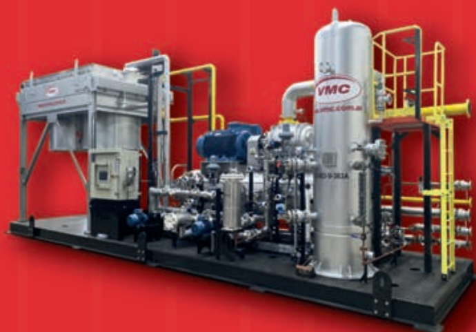
Unidad de recuperación de vapores (VRU) de tanques de petróleo en planta de tratamiento de crudo.
