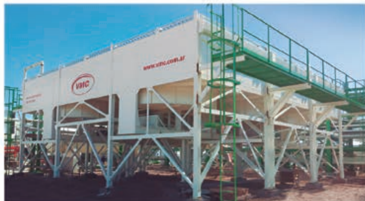
Aerofriador en planta de propano.
