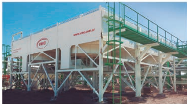
Aerofriador en planta de propano.
